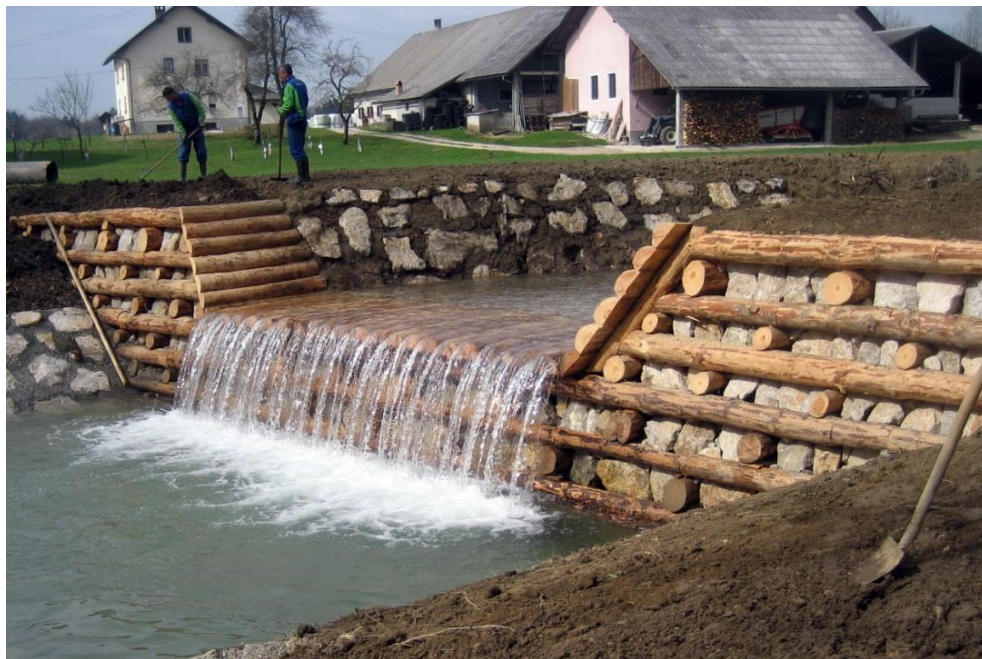
Gradnja kaštnega jez na Pšati v Zalogu pri Cerkljah (foto: J. Papež)
